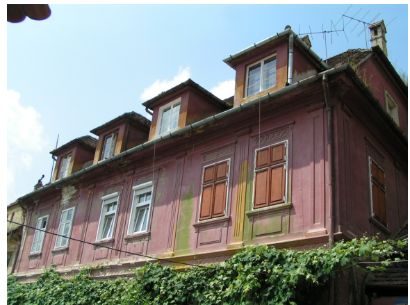
Place de la Cité no. 11: des sept fenêtres de la façade, seulement deux ont été rénovées.
