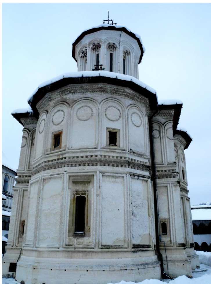
Biserica Sf. Constantin și Elena, înainte de restaurarea fațadelor Fațada de nord și fațada de est cu absida altarului.
